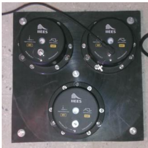
شکل ۸-۱: نحوه‌ی نصب سنسورهای شتاب‌نگاری HAT-IIIES در ایستگاه دماوند
